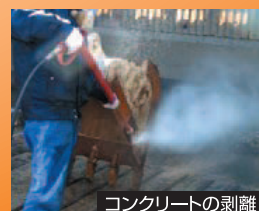
コンクリートの剥離
