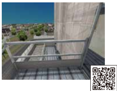
④ 足場墜落災害
