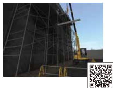
⑥ 玉掛作業失敗による飛来災害
