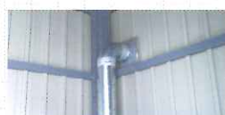
自然換気ダクト
